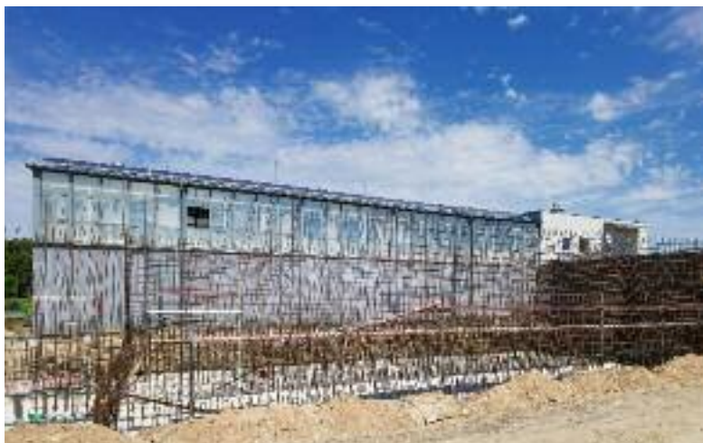
5. Oczyszczalnia ścieków w Niedzwicy Dużej
